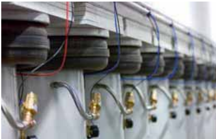
Die Anlage steht auf einer stählernen Plattform, die in einem Betonfundament verankert ist. Unter dem 980 Tonnen schweren Fundament befindet sich ein Lager mit 36 mit Luft gefüllten Gummikissen, die das Gebäude von den Kräften isolieren, die der Versuchsstand freisetzt.
